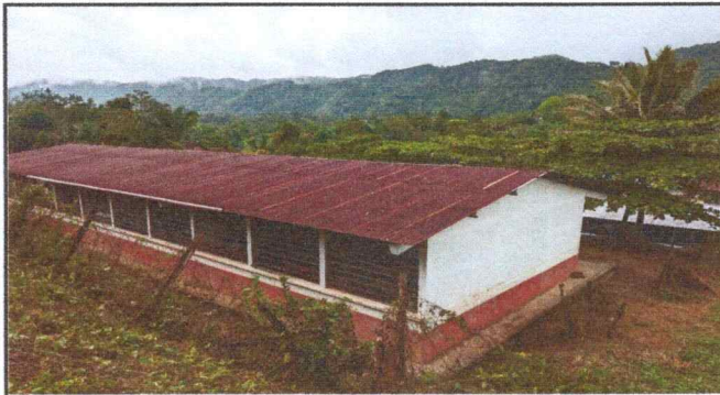
Foto1: SE OBSERVA EL DETERIORO DE LAS LAMINAS. MODULO #2 AGUA 1
