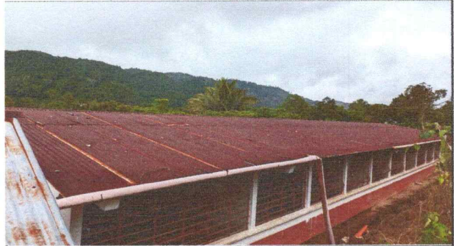
Foto 2: SE OBSERVA EL DETERIORO DE LAS LAMINAS. MODULO #2 AGUA 2
